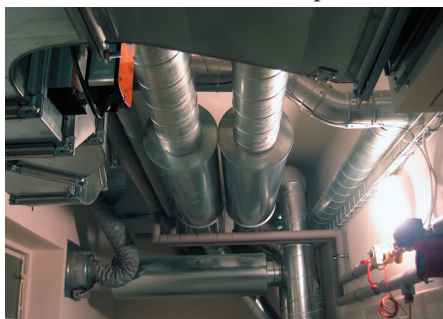
Rozvody vzduchu a topné vody ve strojovně
