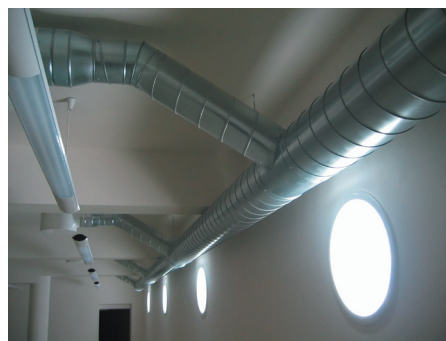
Rozvody upraveného vzduchu
